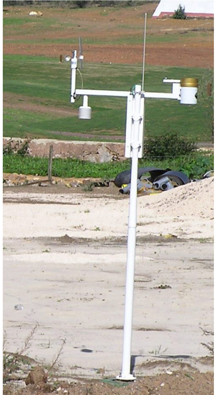
Kuva 5. Sääasema, joka laskee kokonaishaidunnan (ET 0 ) lämpötilan, auringon säteilyn, tuulen nopeuden ja suhteellisen kosteuden perusteella voidaan liittää osaksi kastelujärjestelmää (Kuva: Agnar Kvalbein).
