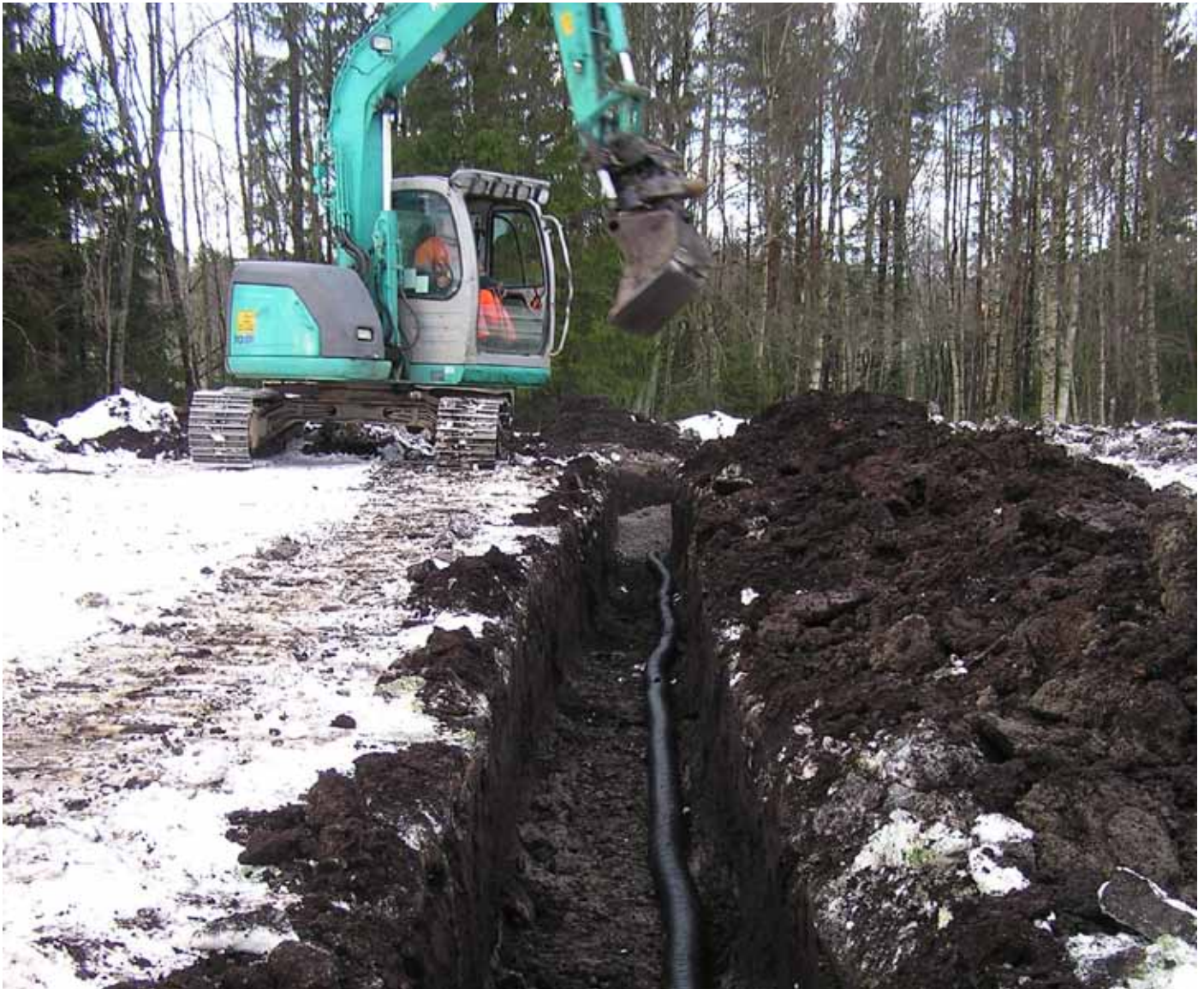
Bilde 1. Dreneringsrør gjør det mulig å senke grunnvannspeilet i jorda. Foto: Agnar Kvalbein.
